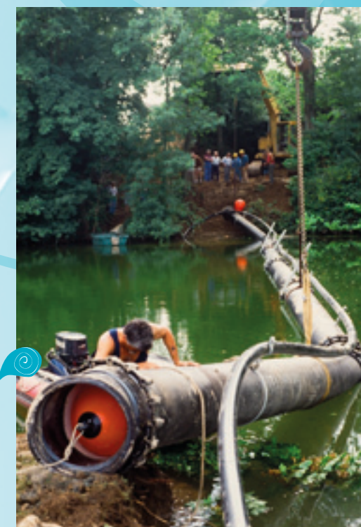
Une vanne majeure a subi une casse irréparable. Une vanne neuve (600 cm de diamètre) a été acquise pour la remplacer.
